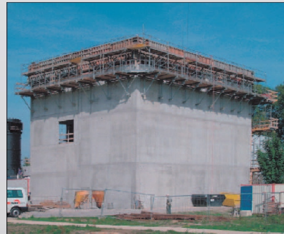
Elektrociepłownia Scharnhäuser Park, Ostfildern-Scharnhäuser
